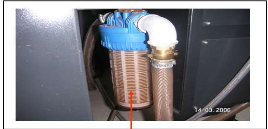
Fig 5 Nettoyage des filtres à eau
